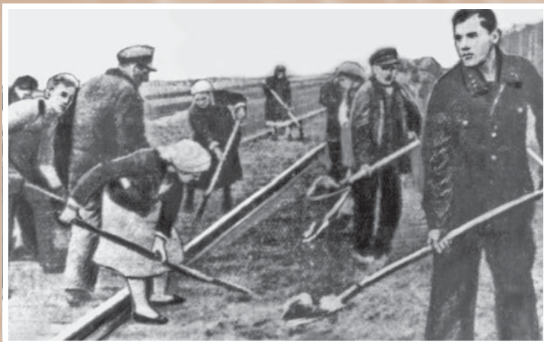
Воскресник по укладке узкоколейки для перевозки оборудования эвакуированных предприятий от станции Омск-сортировочная до строительной площадки (сейчас это территории производственных объединений им. П. И. Баранова и «Полет»). Осень 1941 г. Из фондов МИСО
