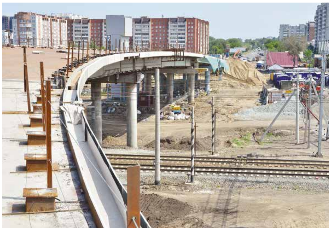
Открытие путепровода на пересечении улиц 15-я Рабочая и Хабаровской намечено на сентябрь 2016 года
