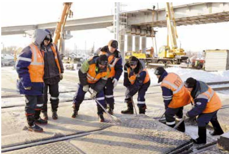
В 2016 году будет сдан в эксплуатацию очередной путепровод — на пересечении улиц 15-я Рабочая и Хабаровская
