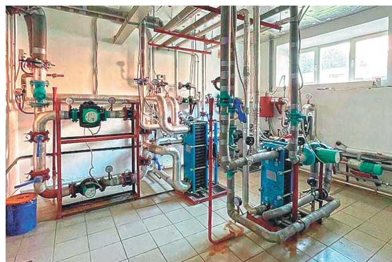
Тепловой узел по адресу: Красный Путь, 143/3
