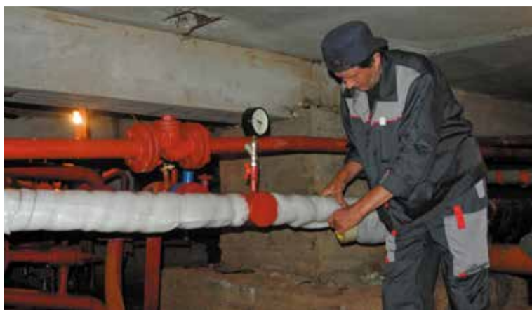
С началом отопительного сезона тепло поступит в 1250 многоквартирных жилых домов округа
