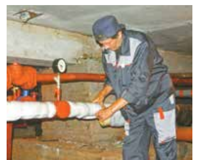
Подготовка к отопительному сезону завершена
